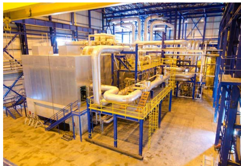
Casa máquinas Flores IV – Interior
