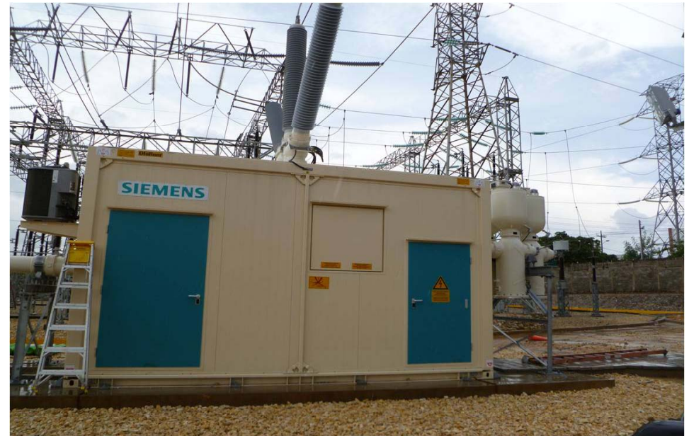
Subestación encapsulada - 220kV
