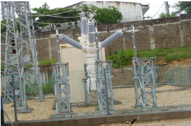
Subestación encapsulada - 110kV
