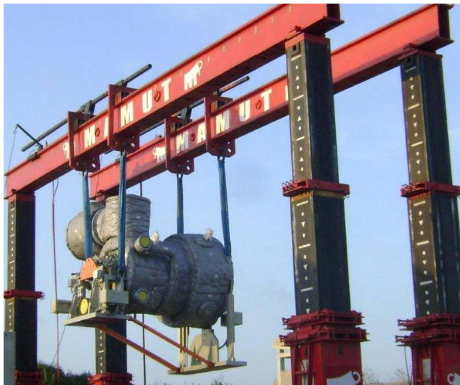
Turbina de vapor
