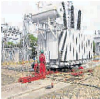
En el sector eléctrico, transformadores y líneas nuevas. ARCHIVO/ADN
