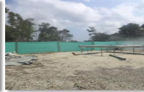
Zona de sandblasting
