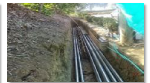
Banco de ductos
