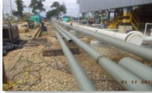
Rack de tuberías
