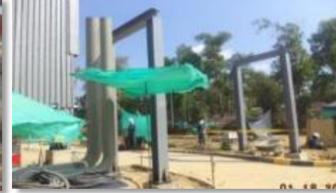
Loop de tubería
