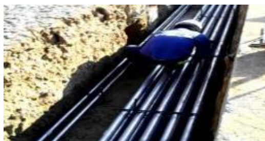
Banco de ductos
