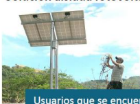
Solución aislada fotovoltaica
